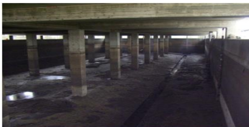
Figura 6 - Reservatório de retenção Subterrâneo.
