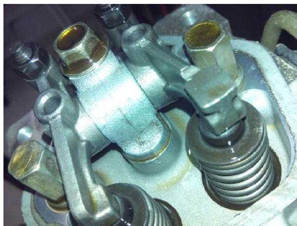
Figura 10. Válvulas do gerador a diesel
